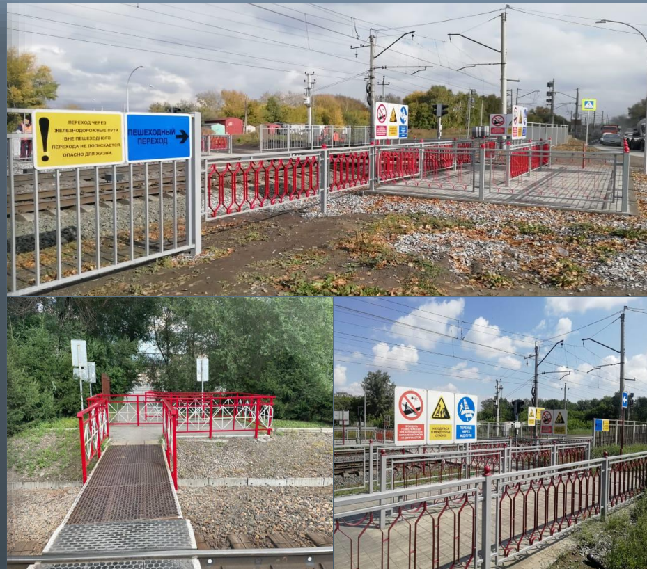
Оборудование пешеходных переходов
